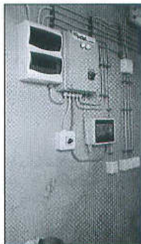
Слика бр.4: Уред за автоматска регулација на вентилаторите
